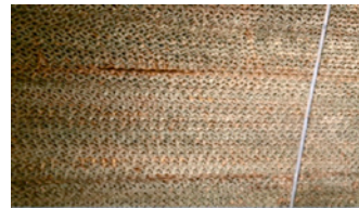
Aussenseite der Kühleinsätze nach der Reinigung
