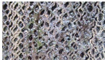
Aussenseite der Kühleinsätze vor der Reinigung
